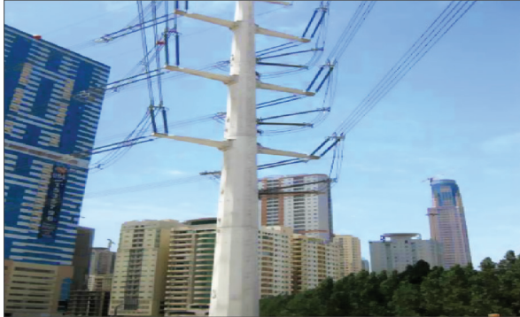
ب. برج نقل أنبوبي أحادي 400 كيلوفولت
