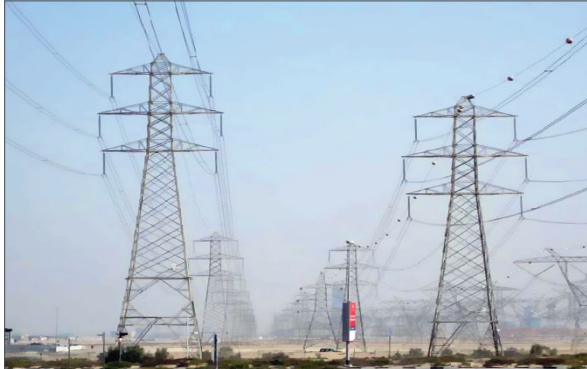
ث. برج شبكي فولاذي 132 كيلوفولت (برج مزدوج الدائرة)
